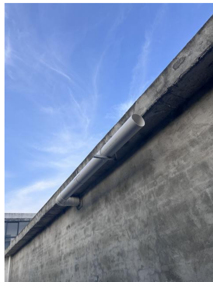
食堂油烟排气管 (生产区)
