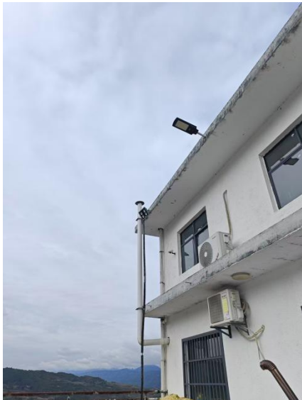
食堂油烟排气管 (办公区)
