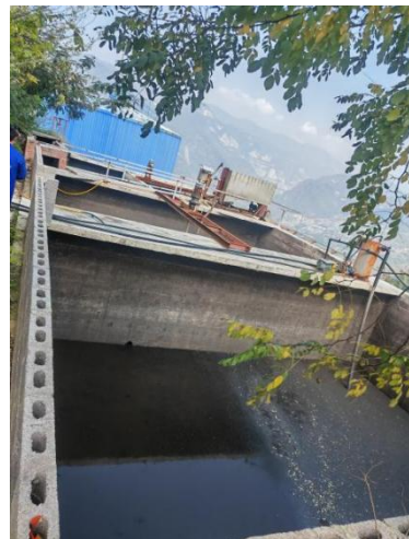
自建污水处理站收集池
