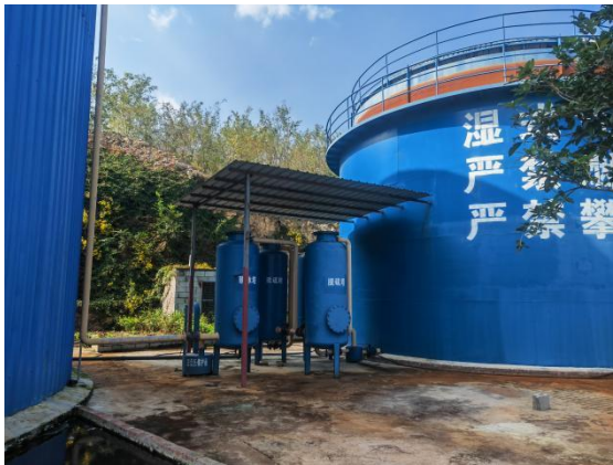
沼气净化设施
