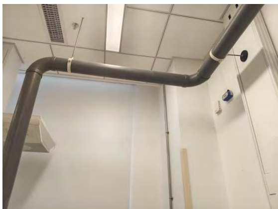
图 3-8.1 515 型 CT 排风管道
