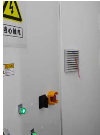
图 3-3.4 电控柜正面急停按钮
