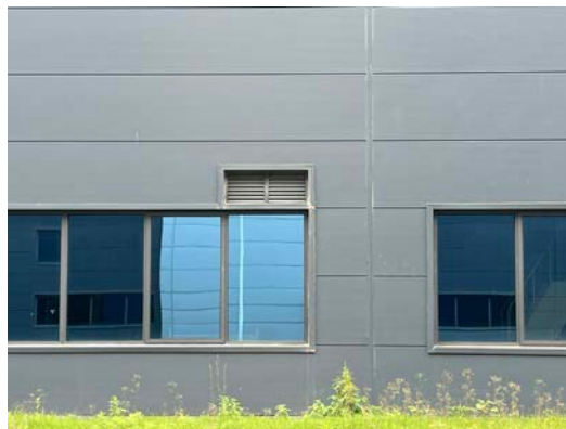
图 3-3.7 CT 室外排风口
