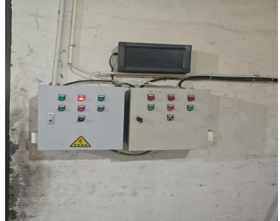
图3-7 防护门控制装置
