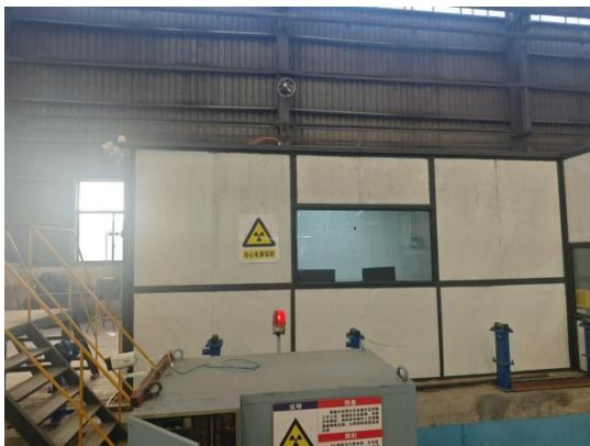
图3-20 X射线实时成像检测系统操作室
