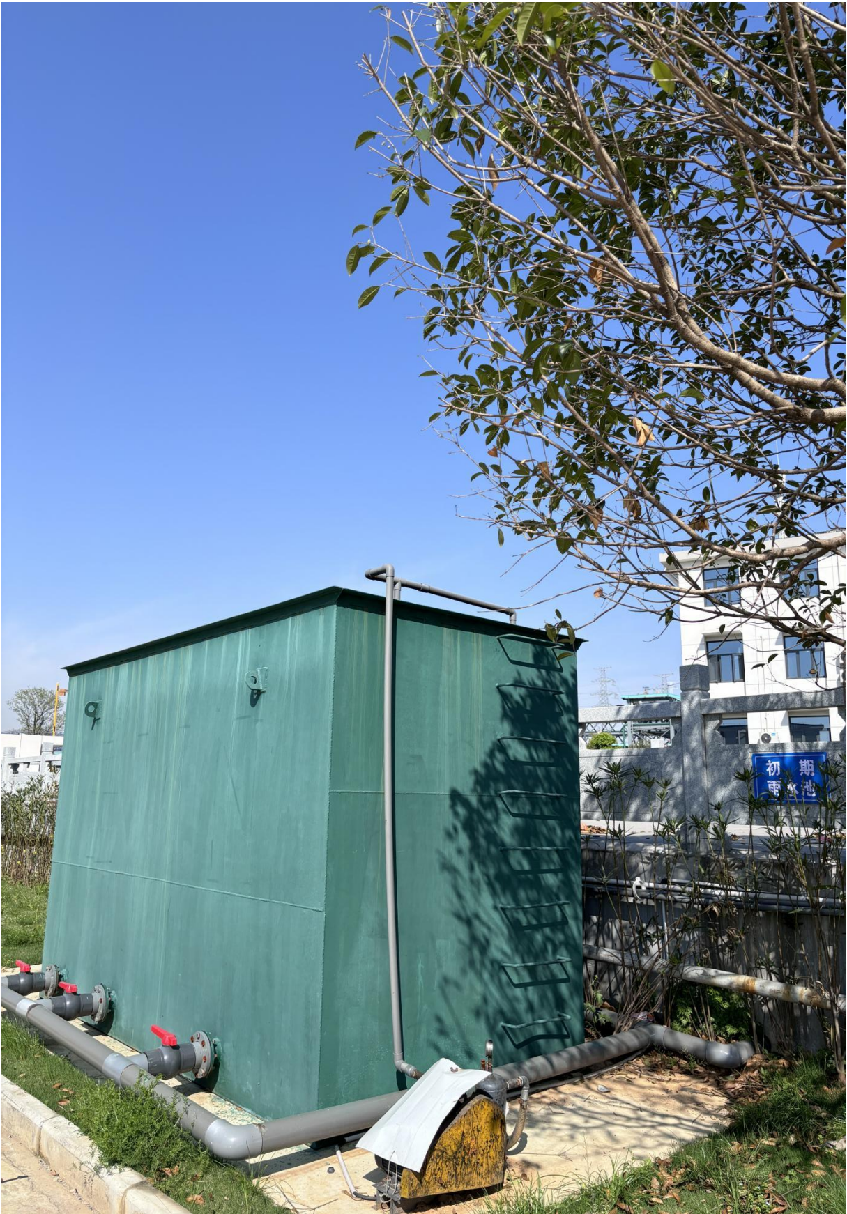
图4.2-2 污水处理装置
